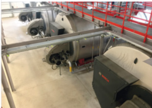
Kogeneračné jednotky v martinskej teplárni
