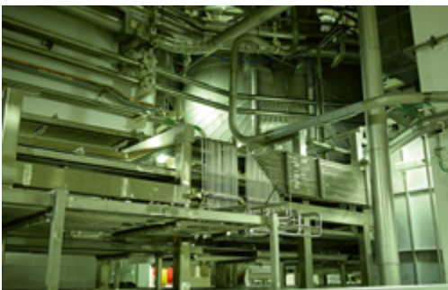
Parogenerátor a impulzné trubkové línie AE Mochovce
