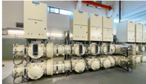
Zapúzdrená rozdovňa 110 kV ES Čulenová
