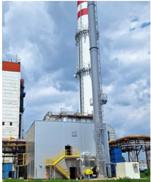
Duslo Šaľa - kotolňa s novým kotlom K8
