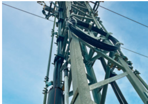
Prechod káblového vedenia VN na vdušné vedenie VN
