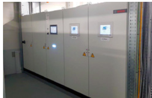
Hlavná rozvodňa v teplárni Slovenských cukrovarov Sereď
