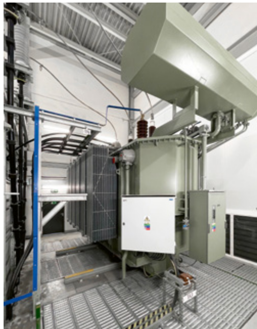
Zapúzdrené stanovište transformátora ES Čulenová
