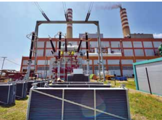
Tepelná elektrárň Planta Centro, Venezuela
