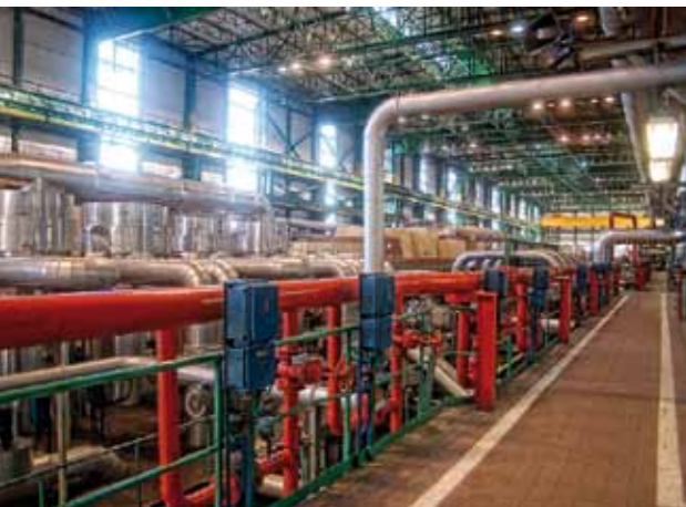
Turbine hall NPP Jaslovské Bohunice
